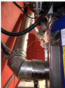
Abbildung 4 Abgasanschluss Gaskessel K3
