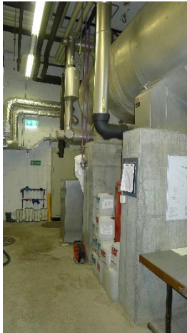
Abbildung 54 NH3-Abscheider / fehlende Auffangwanne
