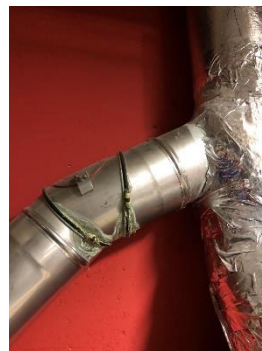
Abbildung 5 Abgasanlage Einbindung in Bestand
