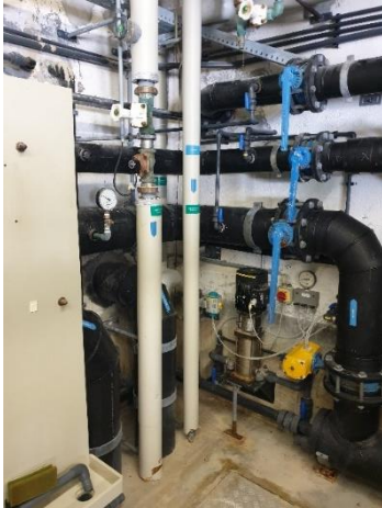
Abbildung 46 Trinkwassernachspeisung BWA Freibad
