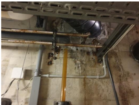
Abbildung 44 Trinkwasseranschluss ans AGB Hallenbad
