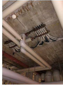
Abbildung 11 FBH-Verteiler an Decke Heizzentrale
