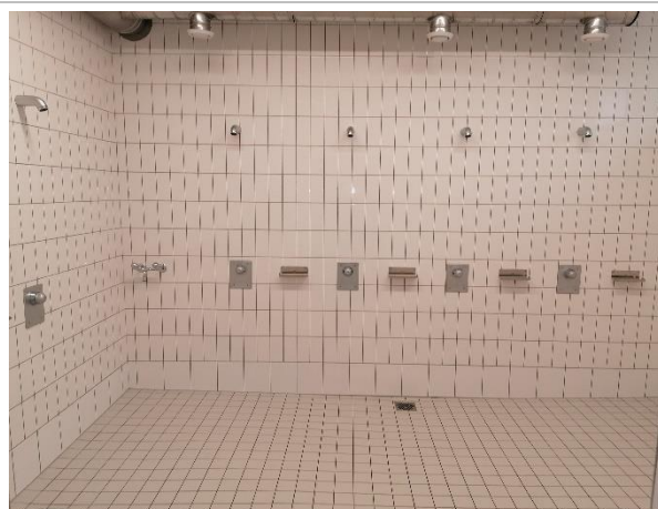
Sanitäreanlagen in Garderobe
