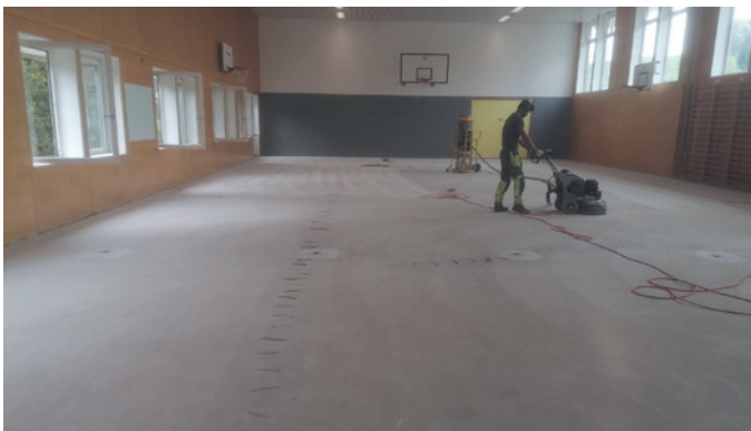
Vor dem Verlegen der ersten Schicht des neuen Hallenbodens musste der Untergrund abgeschliffen werden.
